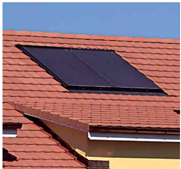
Abb. 1/106: Dach als Energiespender; Solarthermie: Kollektoren zur Warmwassergewinnung in Deckung integriert
